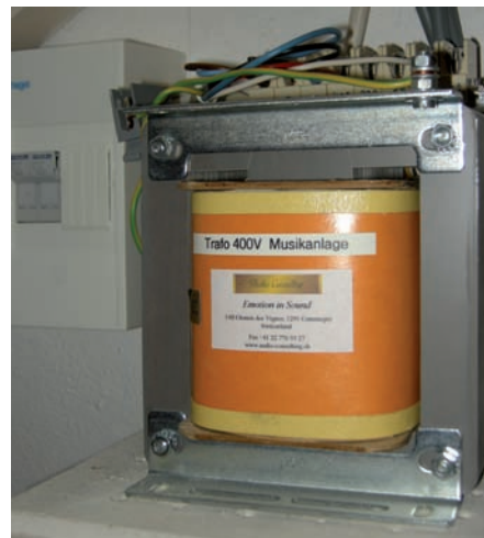
Der grosse zentrale Trenntrafo im Keller
